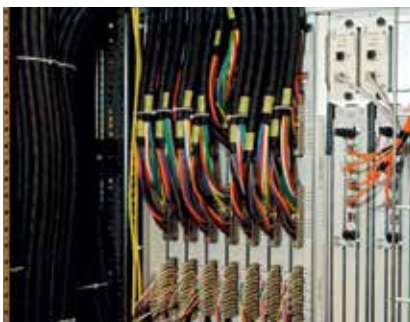
La tête de réseau de Champigny-sur-Marne.
