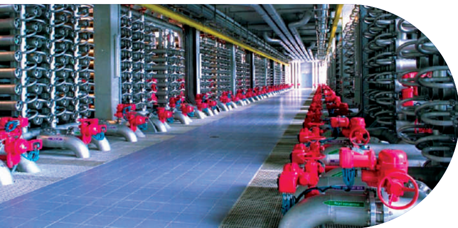
Unité de nanofiltration de l'usine de Méry-sur-Oise
