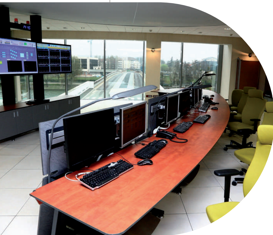
Le poste de commande de l'usine de Neuilly-sur-Marne
