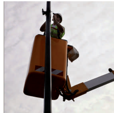
Pose d'un répéteur
