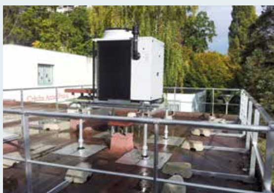
Pompe à chaleur à gaz installée sur le toit de la crèche Anne Frank, à Tremblay-en- France.
