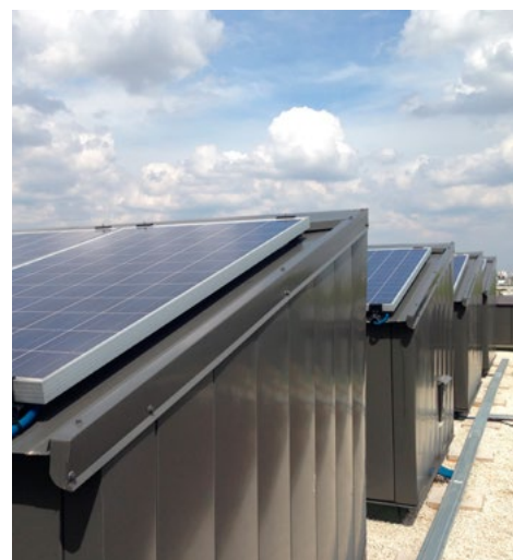
Groupe scolaire Justin Oudin à Issy-les-Moulineaux. Puissance installée : 21 kWc, production d'électricité : 20 400 kWh par an, quantité de CO 2 évitée : 1,8 tonnes par an.
