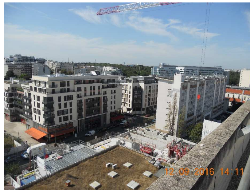
Figure 3.14 : les premiers îlots achevés de la ZAC des Hauts-de-Joinville, rue de Paris
