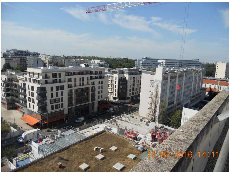
Figure 3.22 : le chantier et les nouveaux immeubles de la ZAC des Hauts-de-Joinville à l'automne 2016
