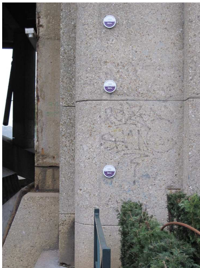
Figure 28 : les repères de crue visibles sur les piles du pont de Joinville
